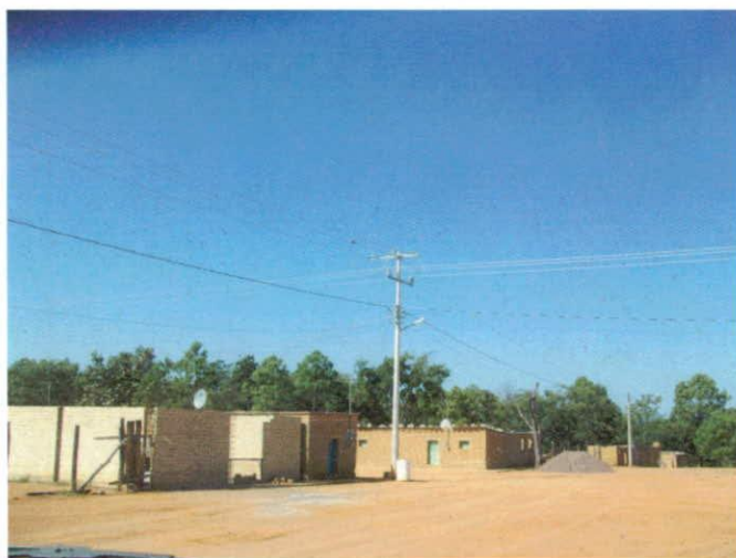
Foto 58, 2010: Torres Contreras. Redes de Energía Eléctrica en la localidad de Pueblo Nuevo en la comunidad de Santa Catarina, municipio de Mezquitic, Jalisco. Por lo regular los huicholes no pueden pagar la energía y se las cortan, esto es lo contradictorio dentro de las condiciones sociales-económicas que promueve el gobierno con los indígenas.
