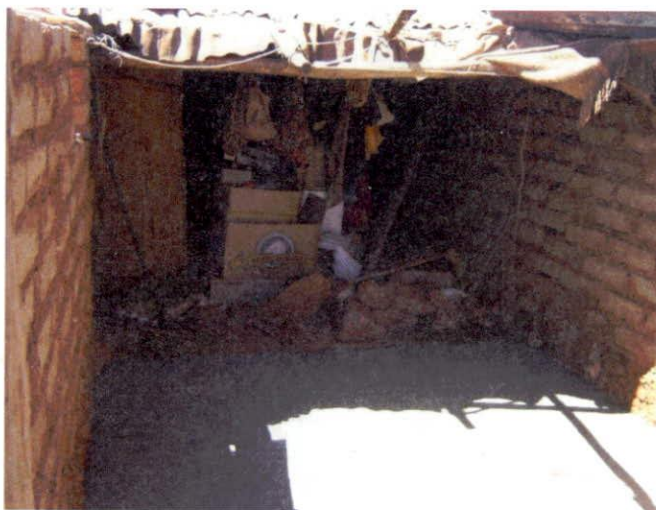
Foto 69, 2010: Torres Contreras. Programa de Vivienda con Piso Firme en San Andrés. Este programa sólo se dio también en San Andrés (cabecera), pues en Santa Catarina, no se implementó por la oposición a la carretera que se andaba construyendo de Bolaños a Huejuquilla el Alto.
