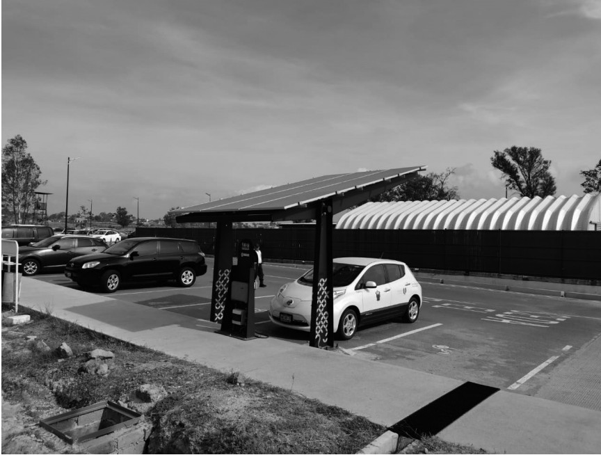
Figura 17. Electrolinería del CUT y vehículos eléctricos
