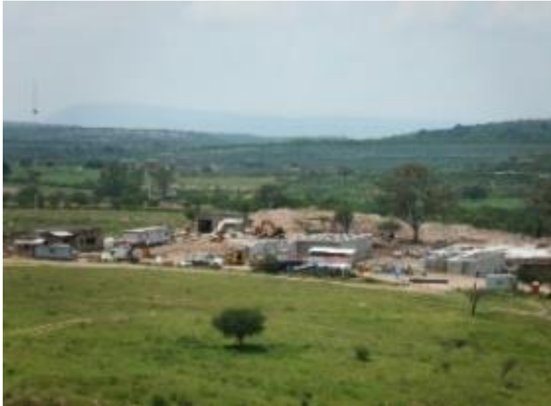
Se observa poco avance en las obras del acueducto.
