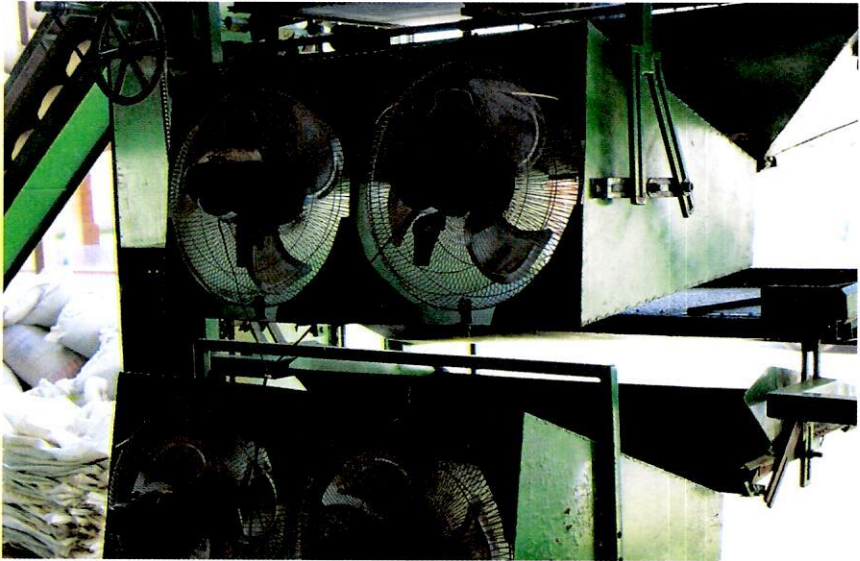
Los ventiladores para la limpieza del grano. The fans used to clean the grain.
